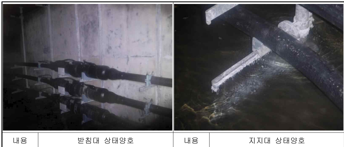
【사진 1.32】 부속 및 부대설비 현황
