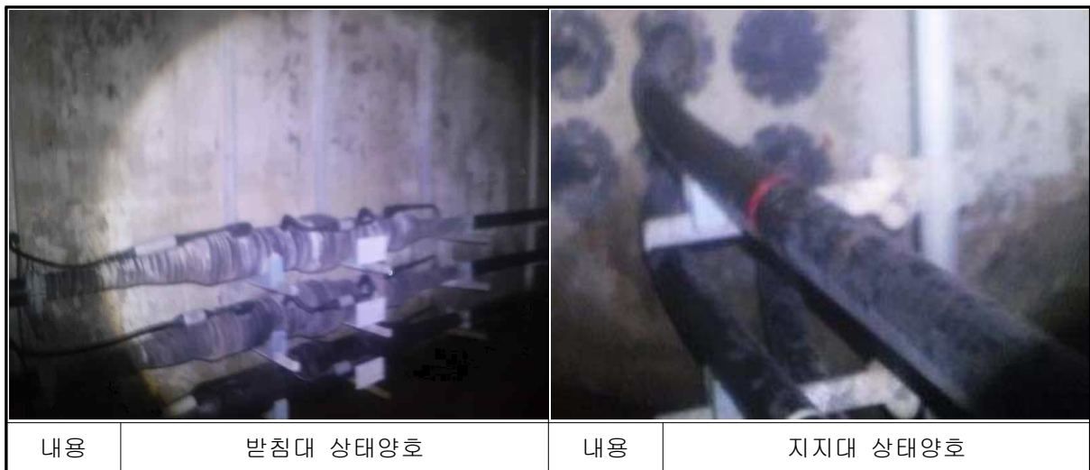
【사진 1.36】 부속 및 부대설비 현황
