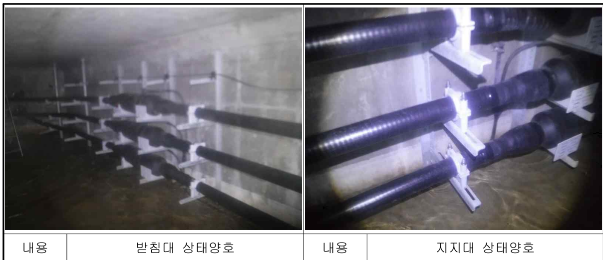
【사진 1.12】 부속 및 부대설비 현황
