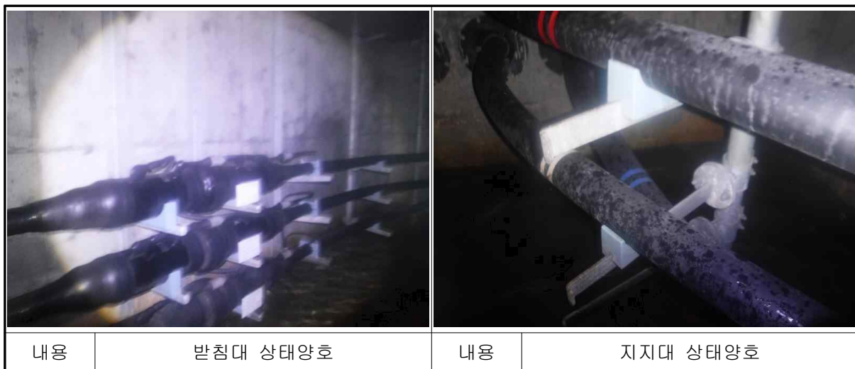
【사진 1.28】 부속 및 부대설비 현황
