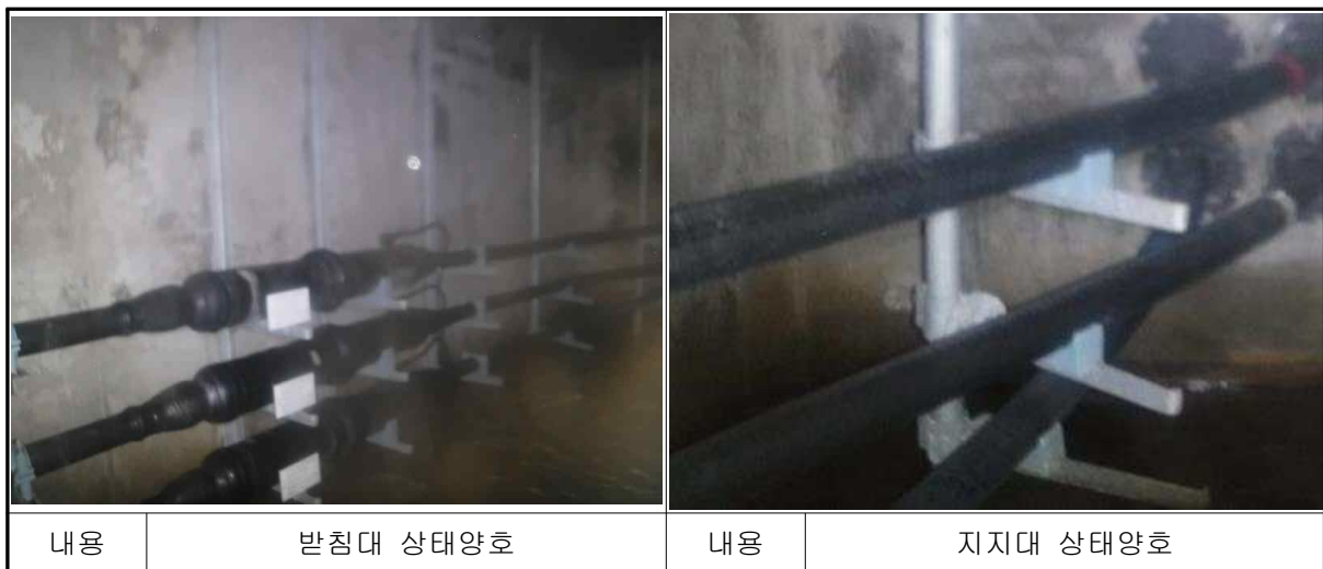
【사진 1.24】 부속 및 부대설비 현황
